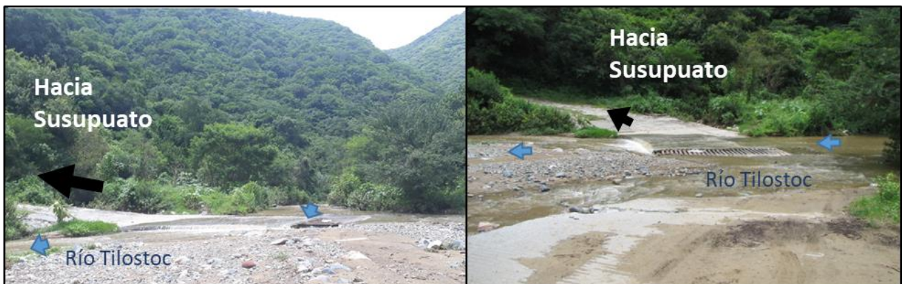
Figura 3. Condiciones actuales de la losa que se emplea para el cruce del río Tilostoc
