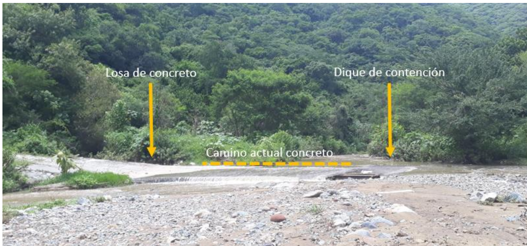
Figura 29. Losa de concreto sobre el “Río Tilostoc” con sedimentación.
