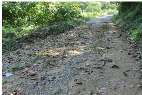
Figura 4. Camino con asfalto deteriorado y sitio de terraplén (1+320).
