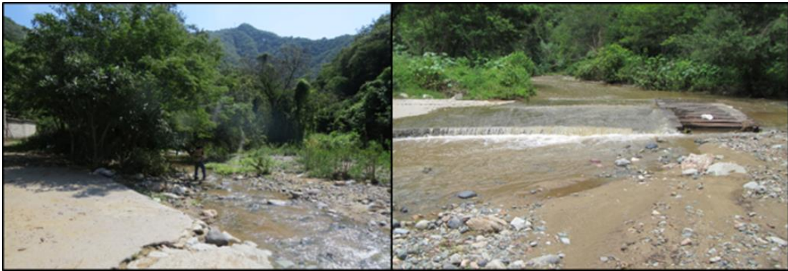
Figura 8. Vista de las condiciones actuales de la losa de concreto por donde se cruza al río Tilostoc.
