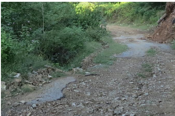
Figura 3. Camino con asfalto deteriorado y sitio de terraplén (1+040).
