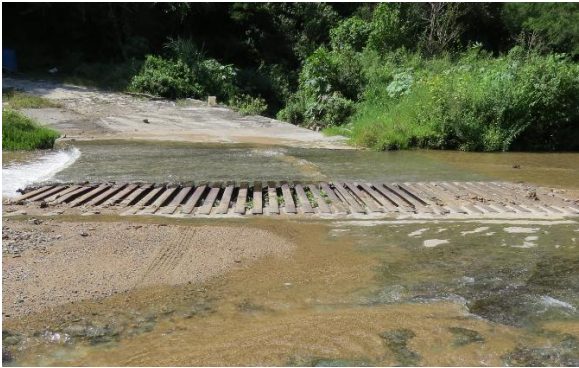
Figura 1. Losa de concreto en sitio de paso sobre el río Tilostoc.
