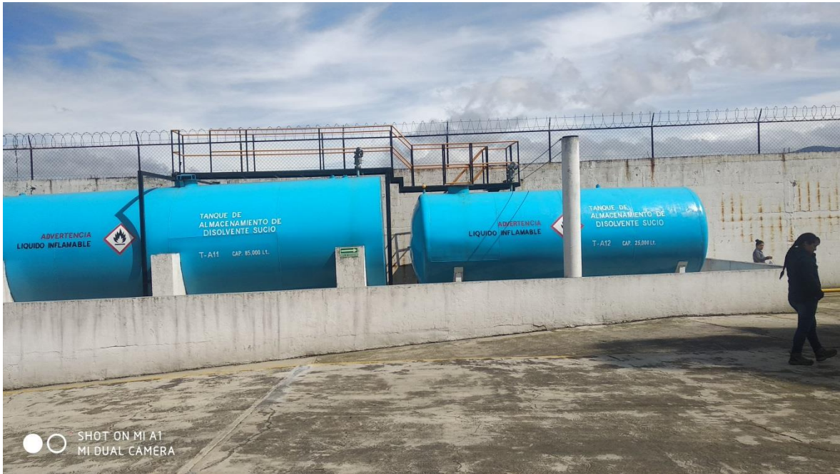
Figura 16. Tanques de almacenamiento de solvente sucio
