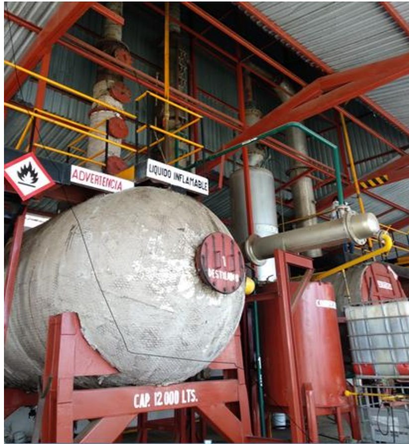
Figura 20. Destilador 1 con capacidad de 12000 litros
