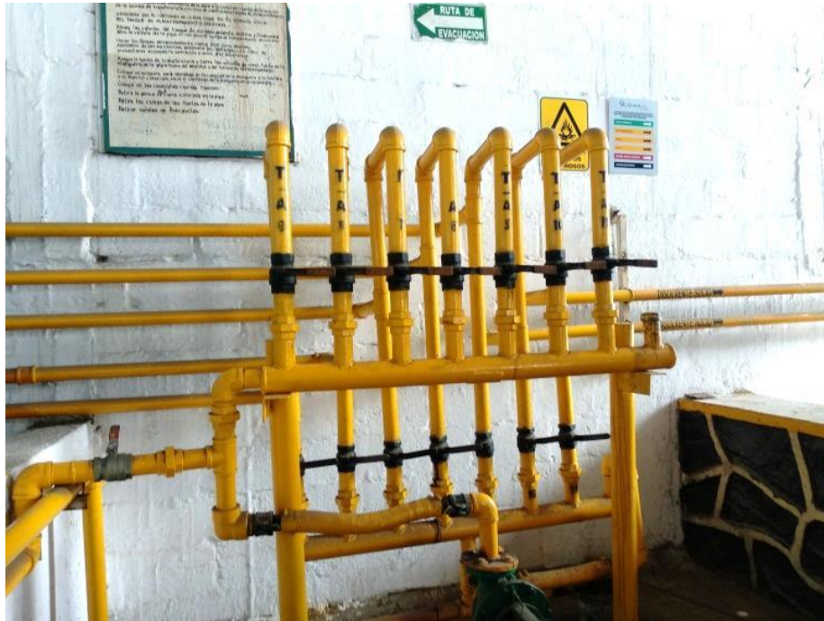
Figura 7. Sistema de bombeo actual para carga y descarga de los tanques de almacenamiento.
