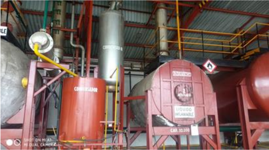
Figura 19. Tanque evaporador y condensador
