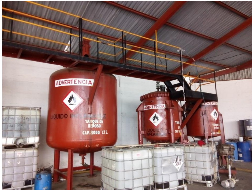
Figura 18. Tanques de sedimentación o reposo
