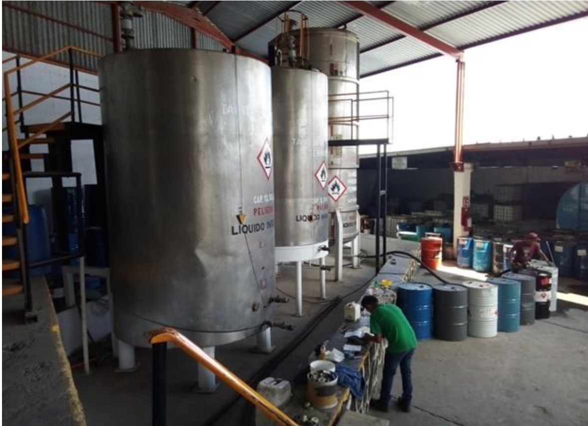
Figura 22. Tanques de formulación y almacenamiento de thinner
