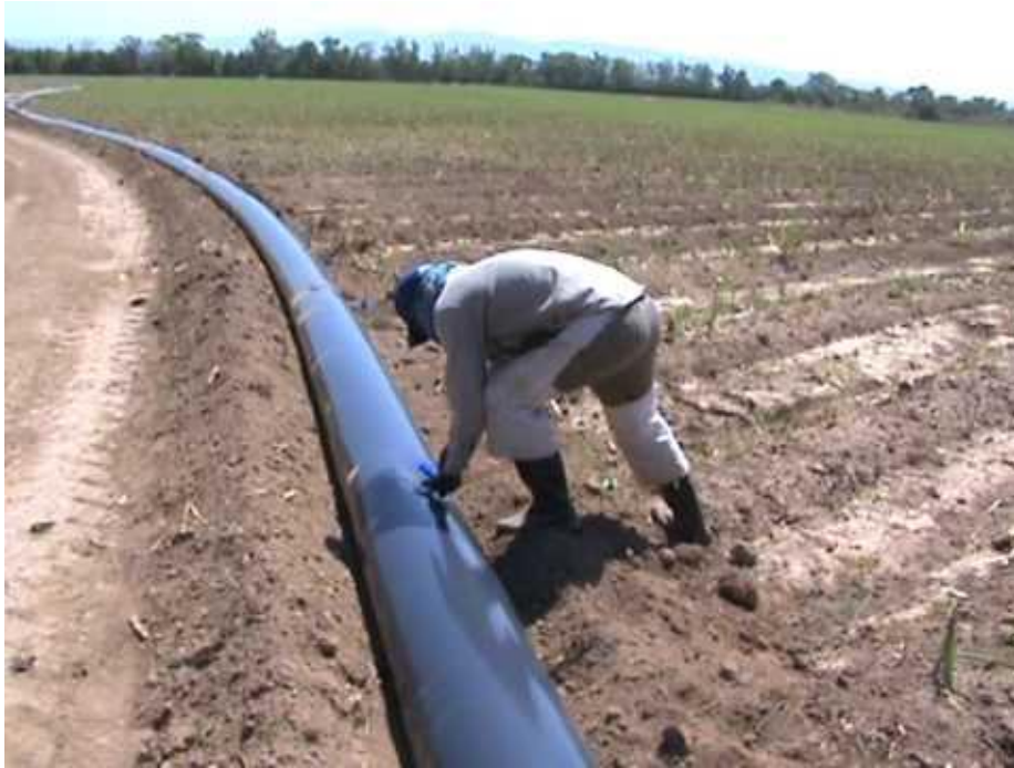
Figura 1 Tubería de 42" enterrada en zanjas con afectación máxima de 2.2 m
