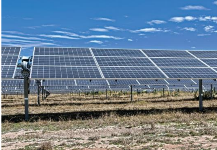
Figura II.26 Ejemplo de paneles fotovoltaicos sobre trackers
