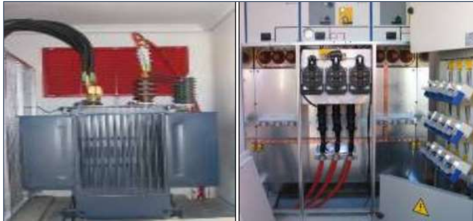
Figura II.21. Transformador y celdas de media tensión
