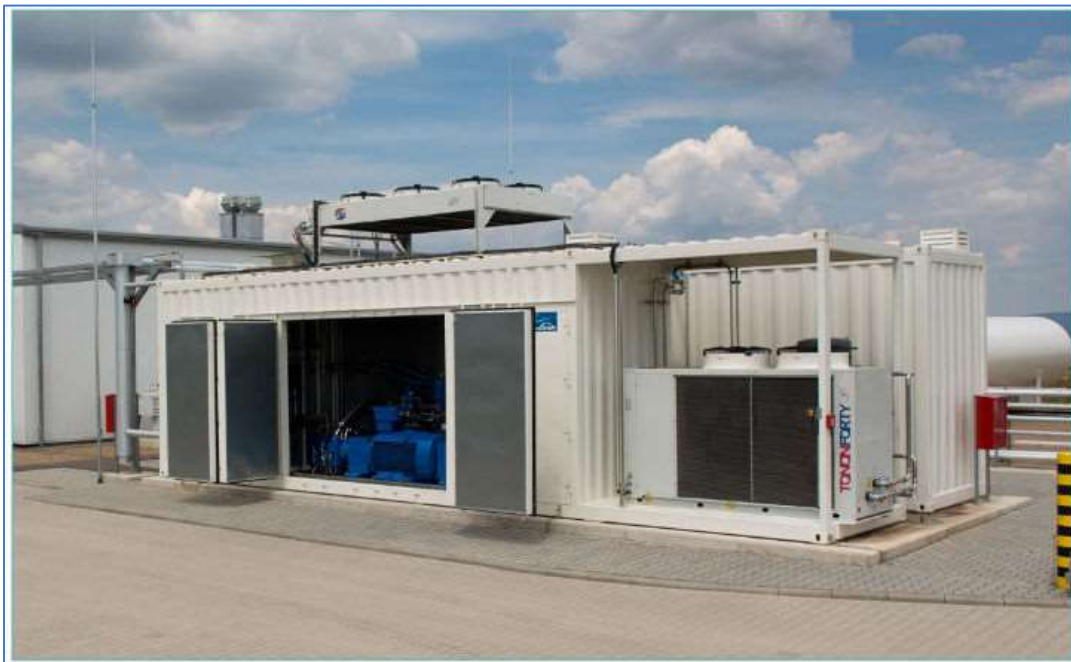
Figura II. 30. 1 Compresor de hidrógeno de alta presión
