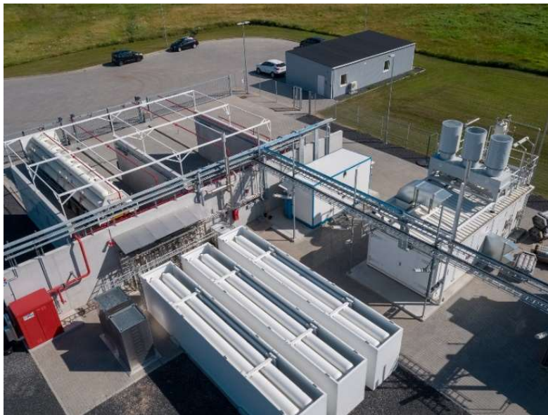
Figura II. 31. Tanques En Forma De Tubos Para El Almacenamiento A Alta Presión
