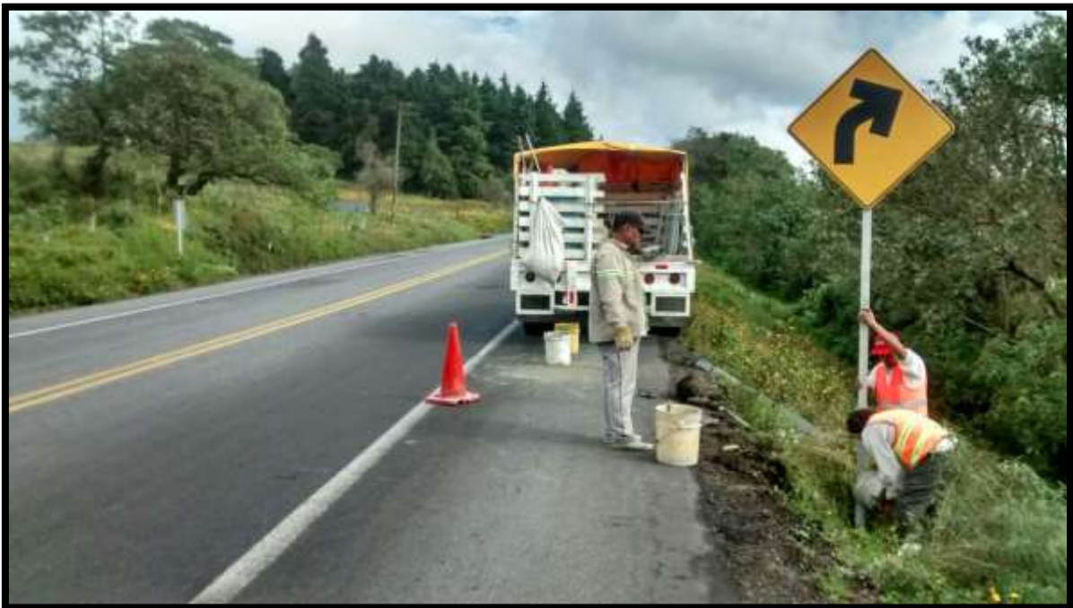
EJEMPLO DE SEÑALAMIENTO EN UNA CARRETERA
