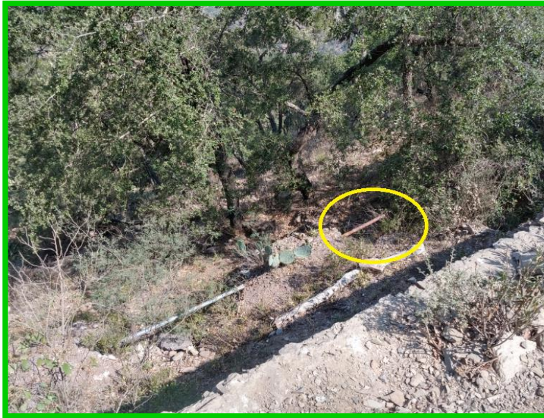
Ilustración 52. Línea de conducción sobre el margen izquierdo del camino principal, en amarillo se observa el deterioro de la tubería superficial instalada hace 35 años.
