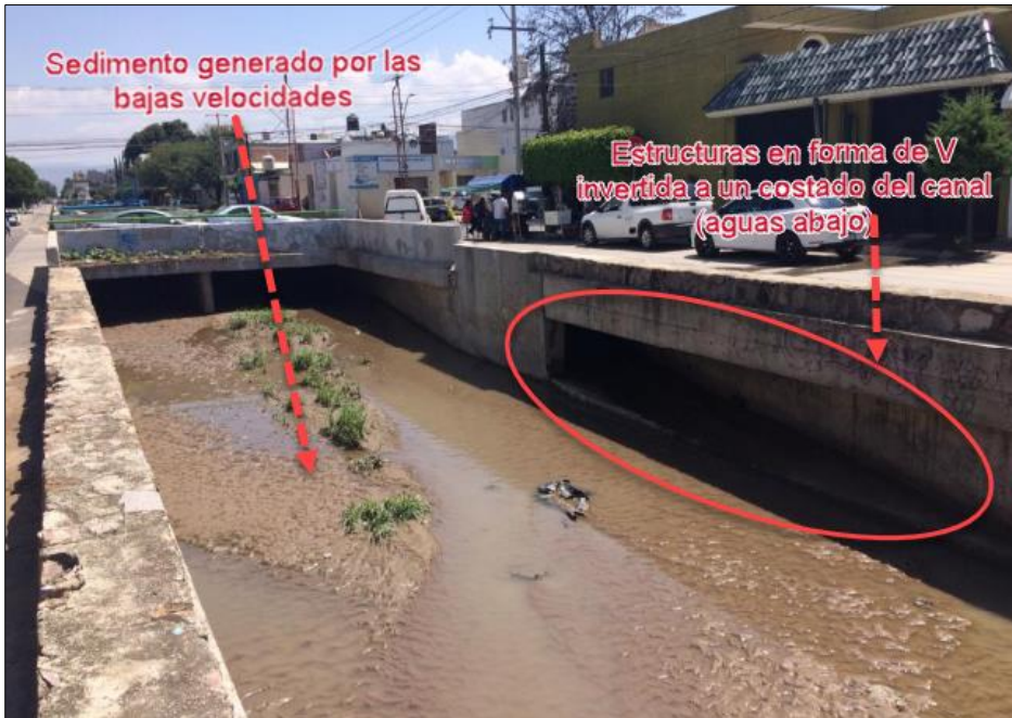
Sedimentos en el cruce vehicular blvd. F. González bocanegra.
