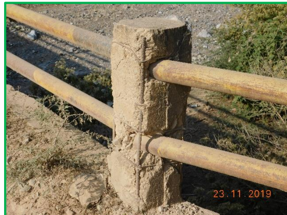
Imagen. Se observa daños en superficie de rodamiento y parapetos de la estructura existente
