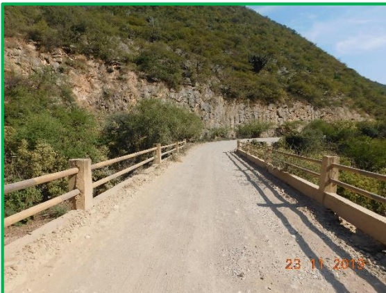
Imagen. Estructura actual en el km. 36+260, se observan daños en la superficie de rodamiento
