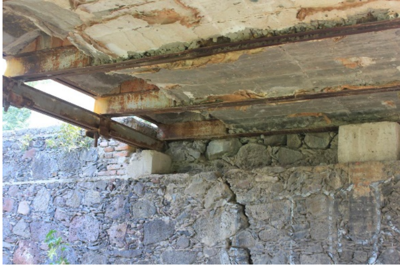
FOTOGRAFÍA 27. Condiciones de los actuales estribos.
