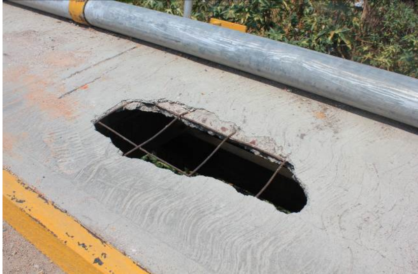
FOTOGRAFÍA 29. Daños en el actual sistema de piso.
