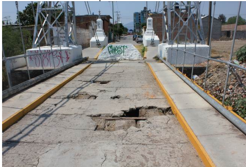
FOTOGRAFÍA 30. Daños en el actual sistema de piso.
