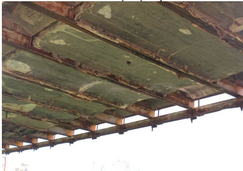
FOTOGRAFÍA 24. Efecto de corrosión de los elementos principales y secundarios.
