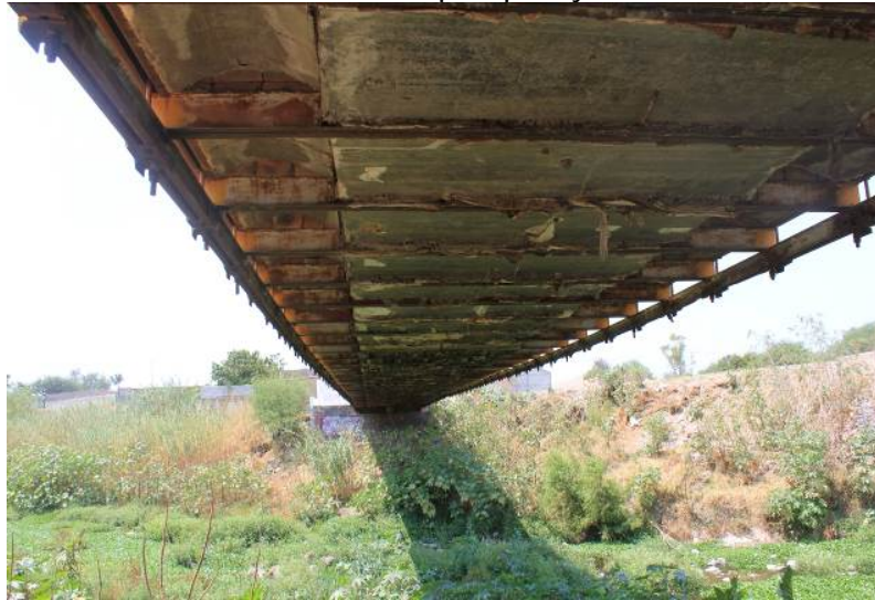
FOTOGRAFÍA 25. Efecto de corrosión de los elementos principales y secundarios.
