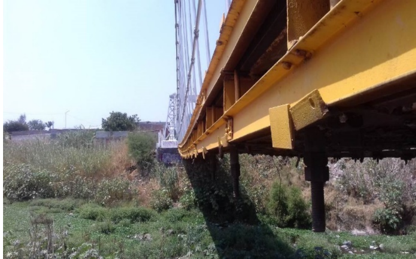
FOTOGRAFÍA 31. Daños del sistema estructural.
