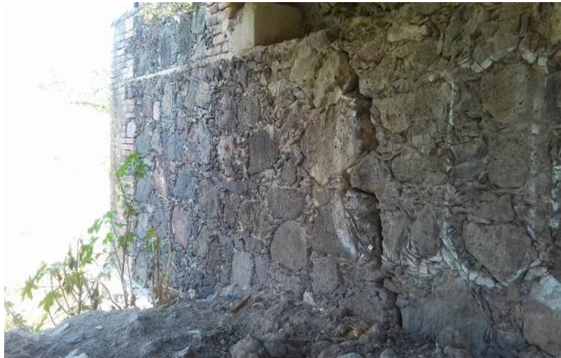
FOTOGRAFÍA 28. Condiciones de los actuales estribos.
