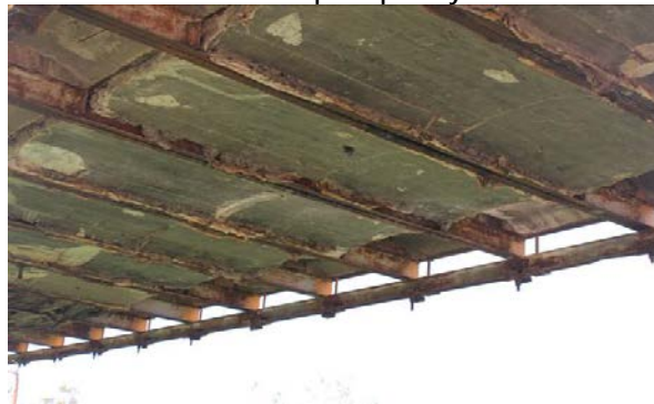
FOTOGRAFÍA 8. Efecto de corrosión de los elementos principales y secundarios.
