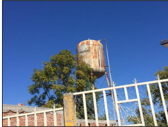
Ilustración 5 Tanque de almacenamiento existente.
