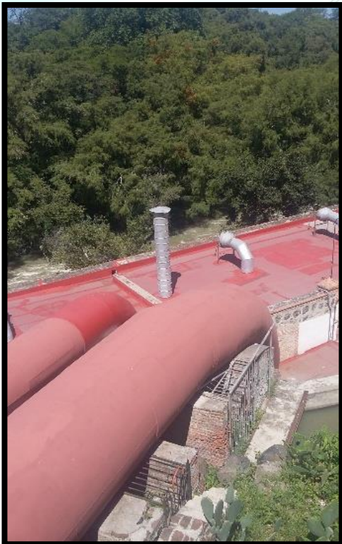
Imagen 14. Llegada a la casa de máquinas
