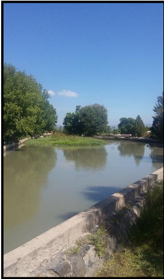
Imagen 10. Tanque de carga
