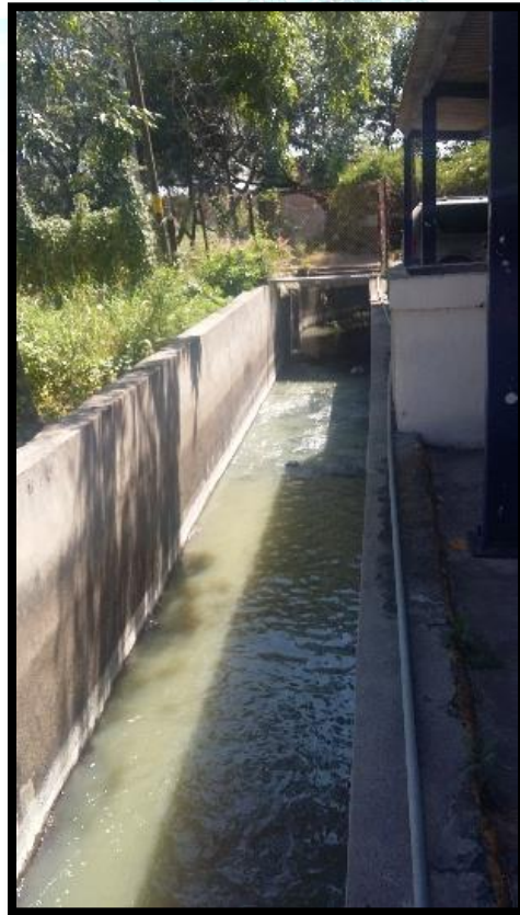
Imagen 9. Canal de Derivación para Riego
