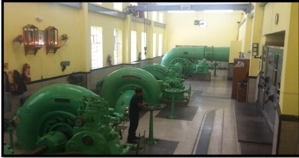
Imagen 17. Interior de casa de máquinas.
