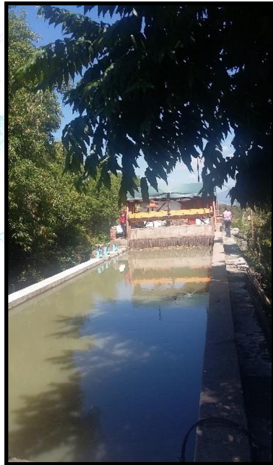
Imagen 11. Rejillas para tubería forzada
