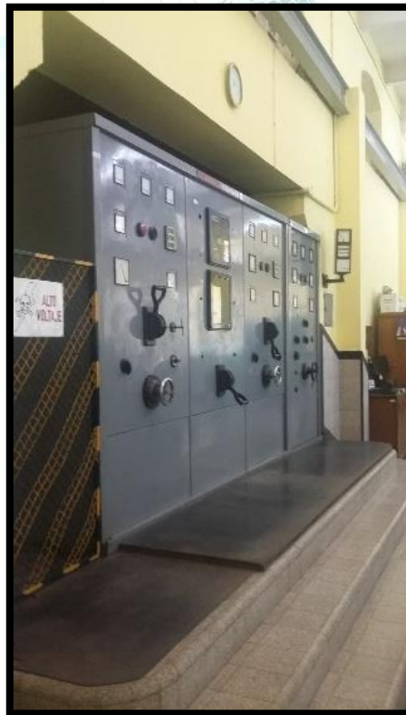
Imagen 18. Centro de Control en casa de máquinas
