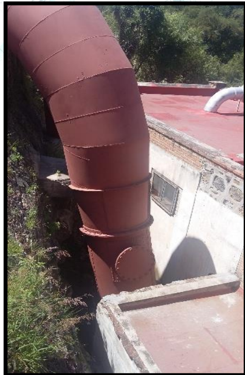
Imagen 15. Tubería de ingreso a turbinas
