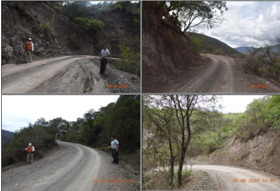
Figura II.10 Vista de las condiciones del subtramo Izotepec - Yextla donde se observa, que en algunas zonas se requiere de la ampliación del actual camino para cumplir con el ancho de corona de 7.0 metros.
