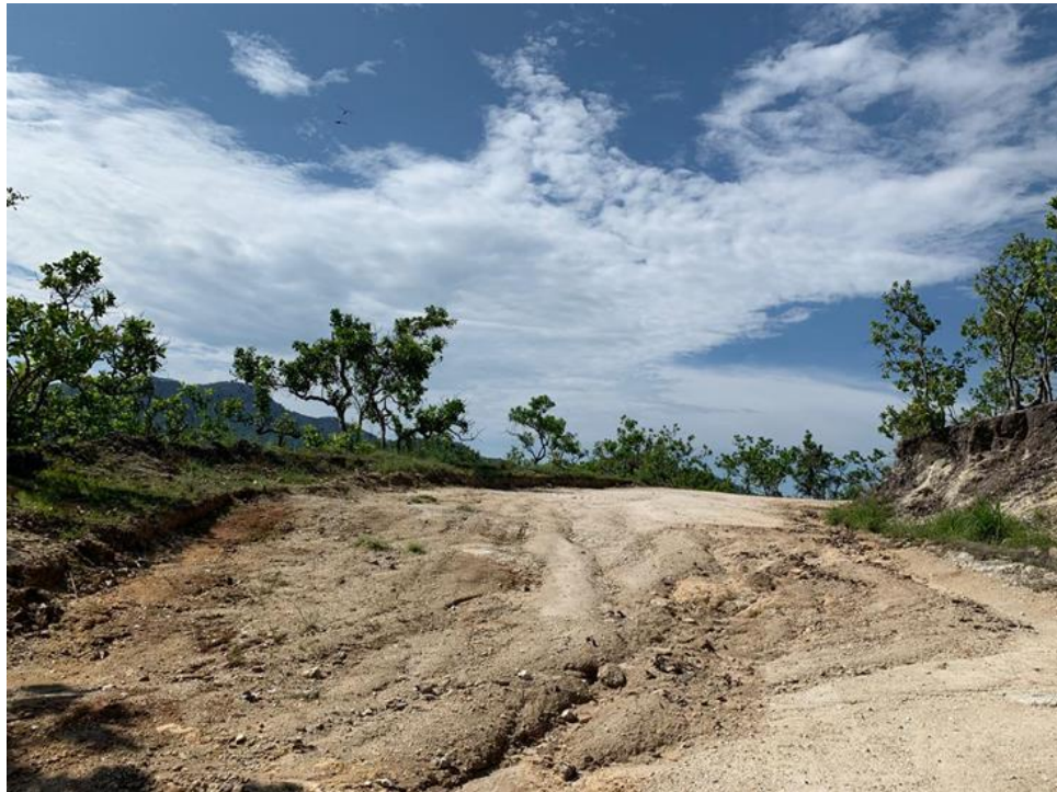
Imagen 61.- La mayor parte del camino cuenta con el ancho de corona requerido, sin embargo hay que recalcar que existen áreas necesarias a reparar. Km. 1+365.
