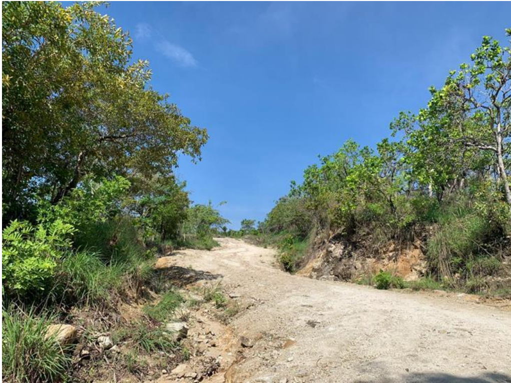
Imagen 58.- En el tramo a modernizar es factible encontrar suelos erosionados por falta de obras de drenaje que conduzca el agua pluvial a los ríos intermitentes.
