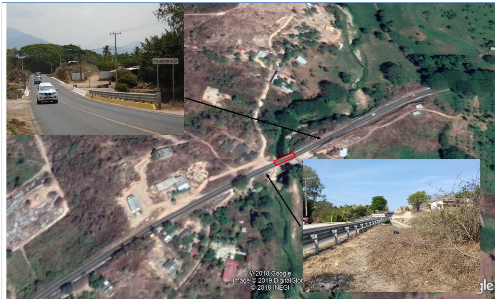
Figura 71. Estado actual del lugar donde se llevarán a cabo los trabajos de reconstrucción del puente
