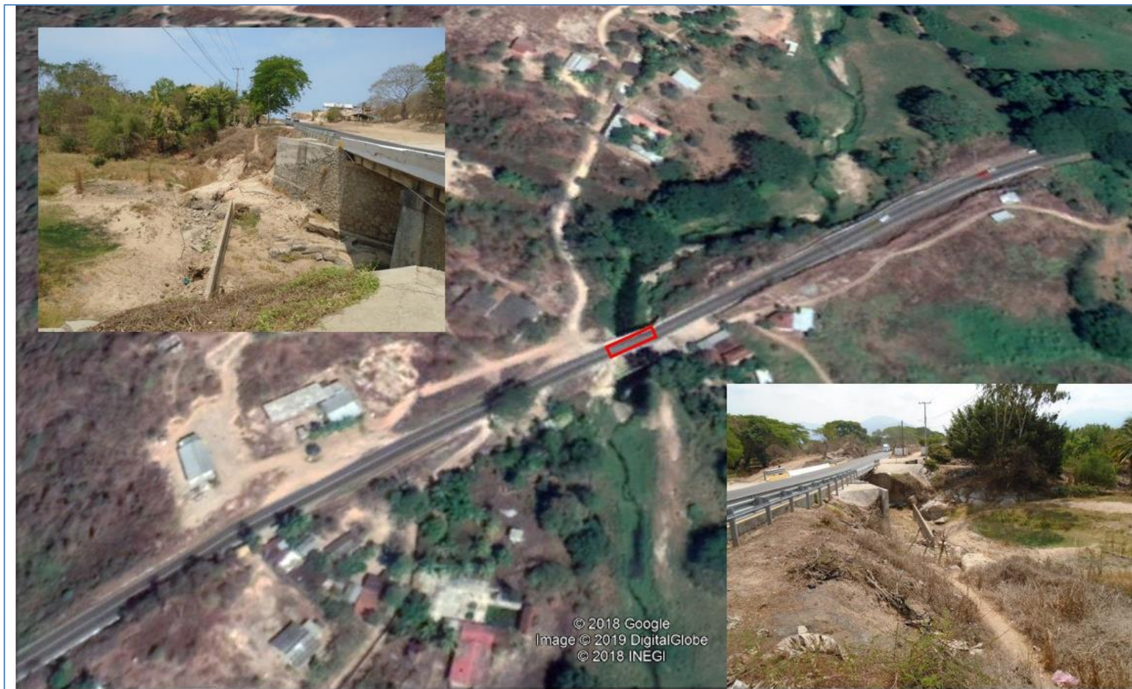
Figura 73. Condiciones en las que se encuentra el puente a reconstruir.
