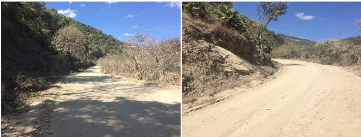
Ilustración 29. Condiciones actuales del tramo carretero, Km. 19+970
