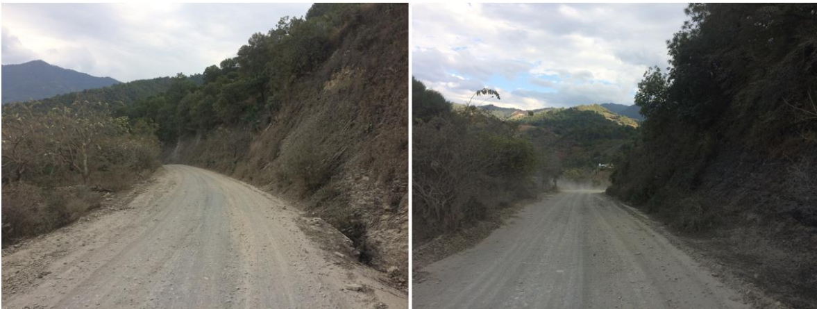
Ilustración 26. Condiciones actuales del tramo carretero, Km. 15+500
