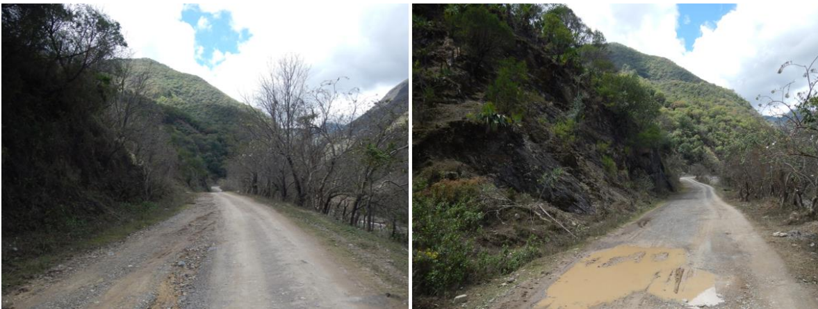
Ilustración 23. Condiciones actuales del tramo carretero, Km. 8+950
