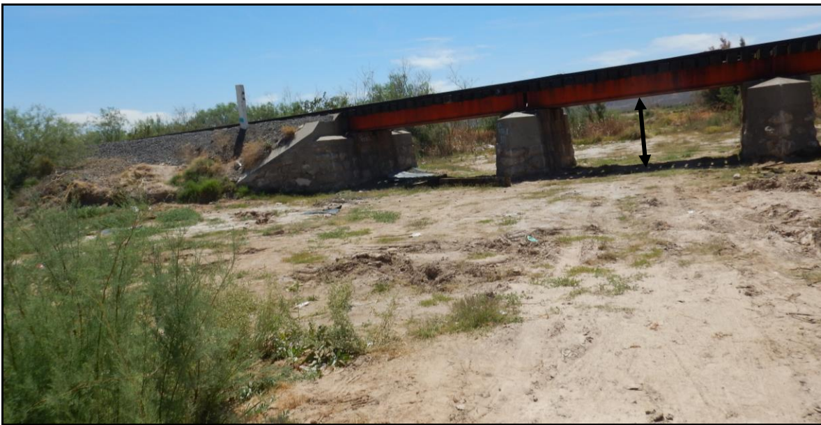
Figura No. 85 Puente del FFCC aldaño a la carretera. El puente tiene una altura de 1.3 m y da un ejemplo del volumen del escurrimiento que atraviesa la carretera.
