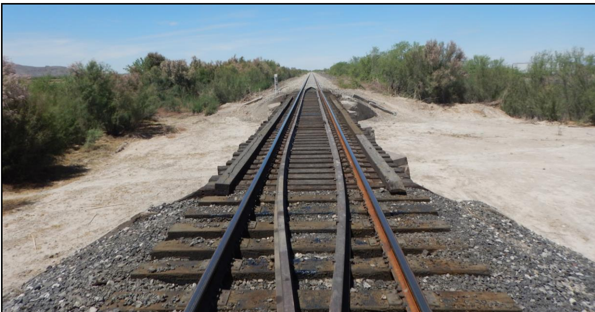
Figura No. 26 Vía de ferrocarril, puente ferroviario que cruza la escorrentía en el cadenamiento del ferrocarril Km. 1110+132.
