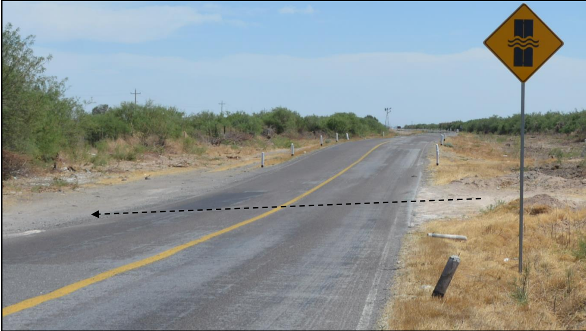
Figura No. 2 Fotografía panorámica de la carretera, vista Sur a Bermejillo, Durango. Se aprecia la carpeta asfáltica con ligero desgaste y la señal que indica el Vado.
