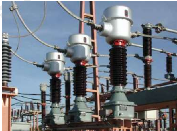
Figura II. 40. Transformador de corriente monofásico
