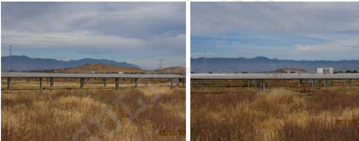
Figura II. 32. Características de instalación de módulos fotovoltaicos.
