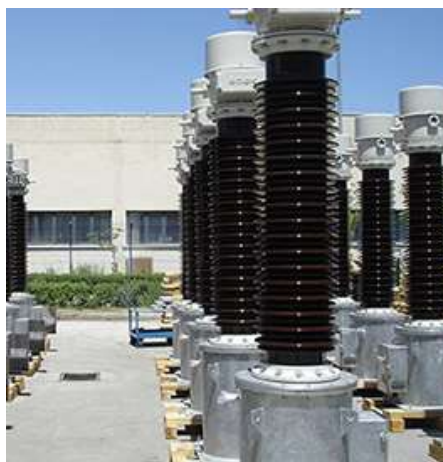
Figura II. 42. Transformador de potencial inductivo
