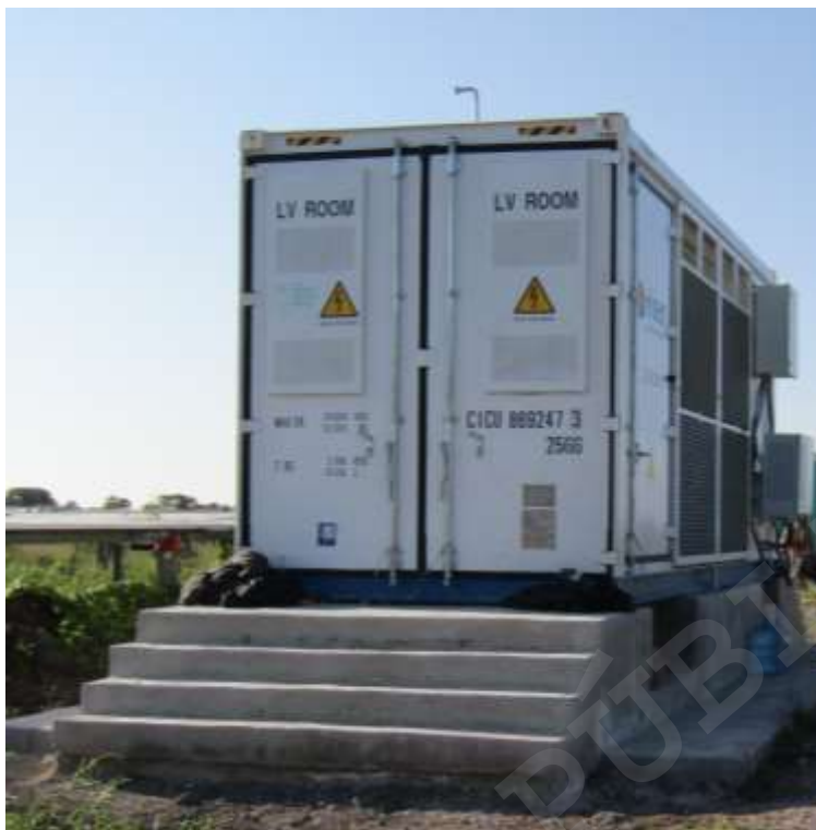
Figura II. 27 Estado actual las estaciones de transformador y estructuras de soporte.
