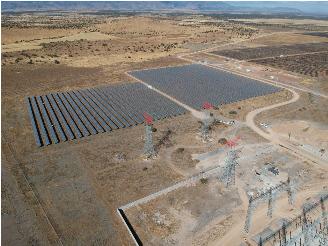
Figura II. 18. Estado actual de las torres de transmisión eléctrica para la interconexión con la LTE 230 kV de la CFE:
