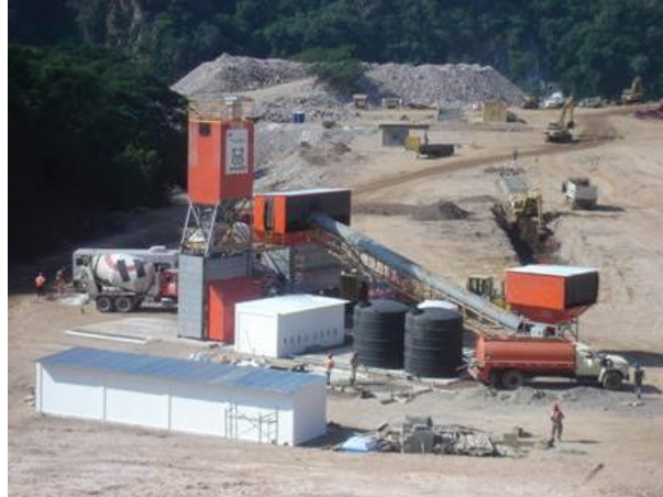
Foto VI.4. Ejemplo de una Planta dosificadora de concreto en el proyecto. 1
