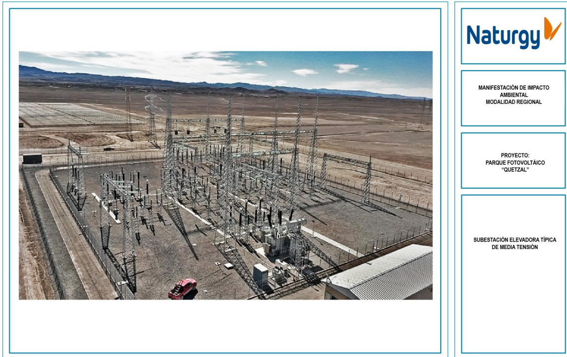
Figura II.11. Subestación elevadora típica
