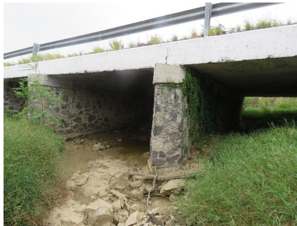
Foto V. 1. Obra de drenaje donde se registró fauna.
