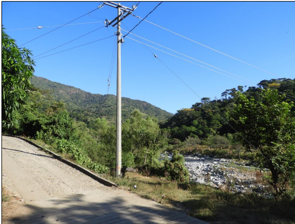
Figura IV-76. La imagen muestra postes de energía eléctrica de media tensión en la localidad de Nueva Francia.
