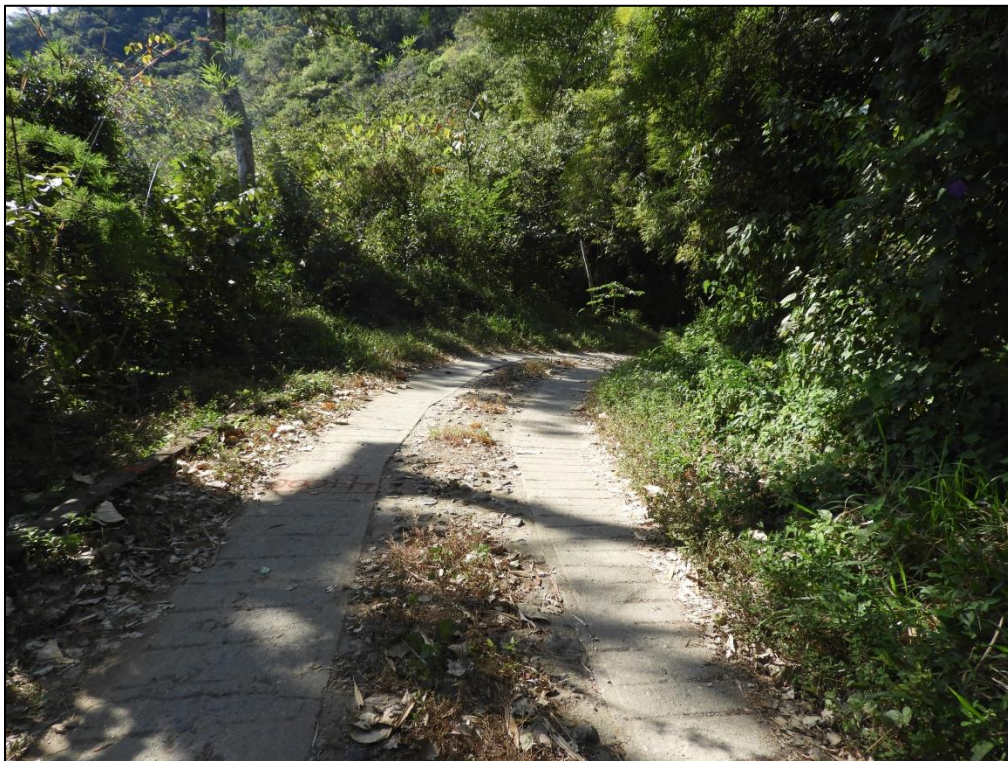
Figura II-6. Vista del Km 5+300, misma que requiere de ampliación.
