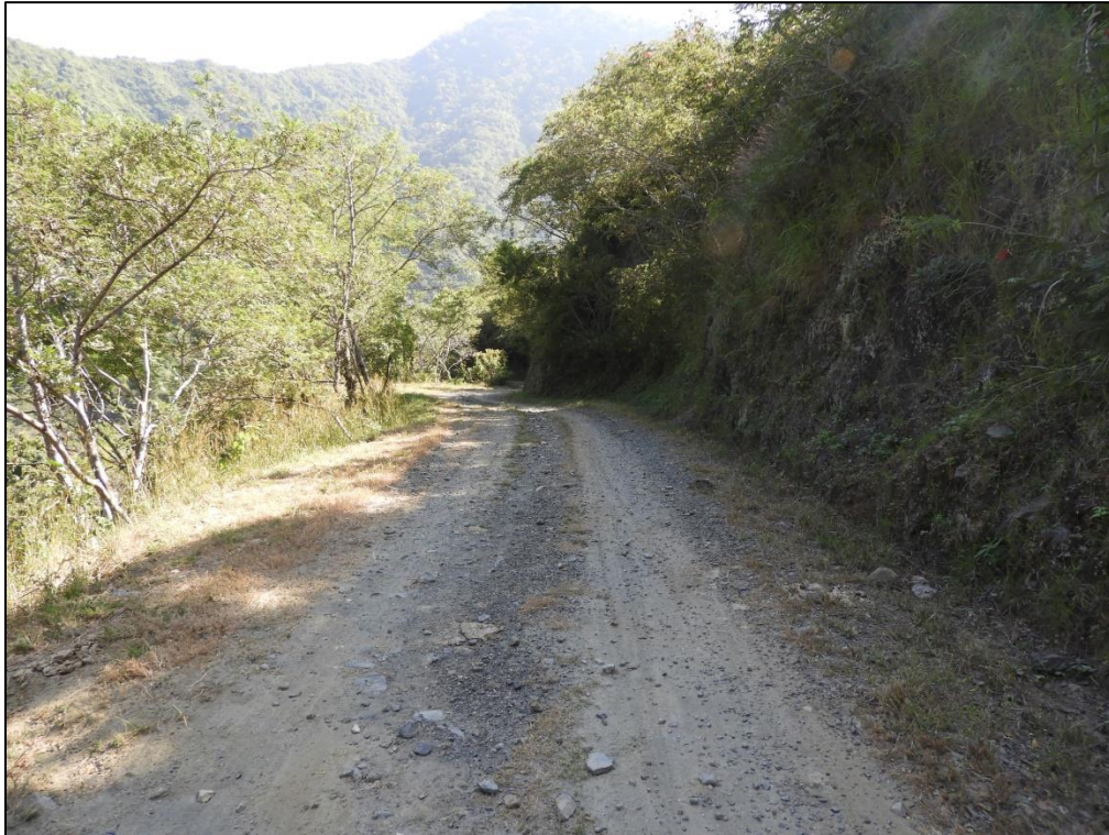
Figura II-9. Vista del Km 7+000 en dirección al Km 6+000, donde el proyecto requiere de cortes y estabilización de taludes.
