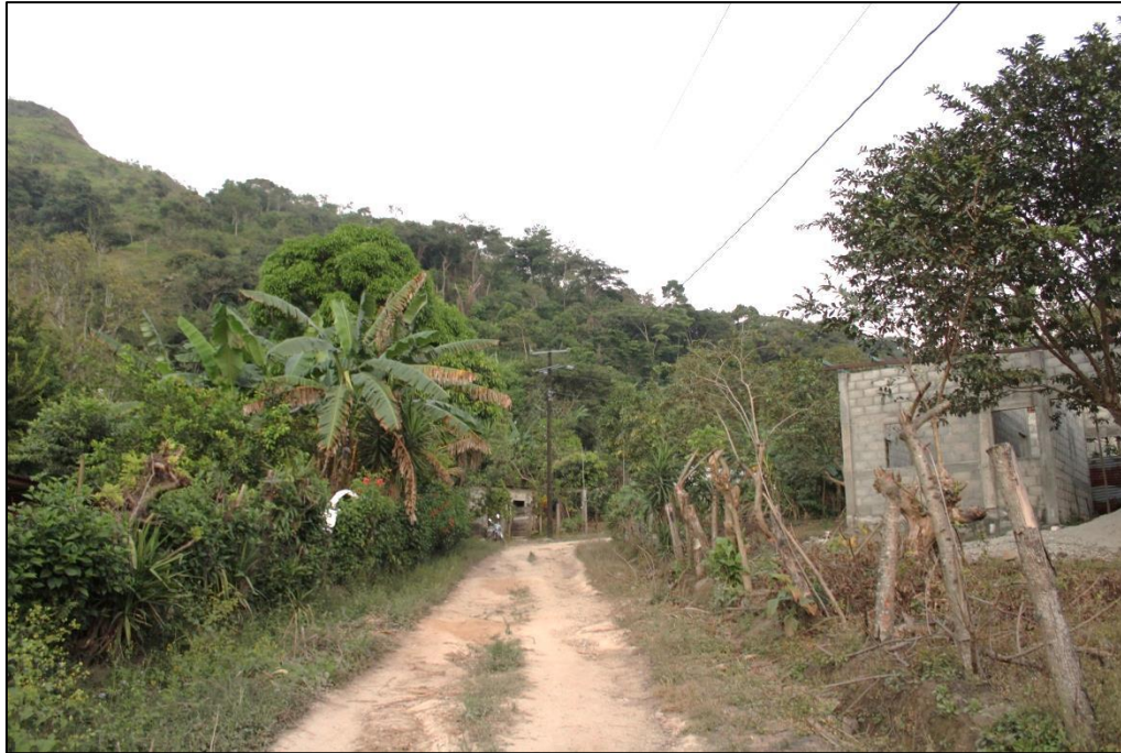
Figura IV-77. La imagen muestra la red de energía eléctrica que existe en la comunidad de Ovando La Piñuela.
