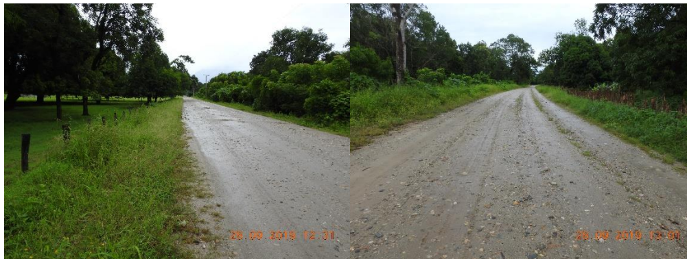
Figura II.2 Vista de las condiciones actuales del camino a modernizarse.
