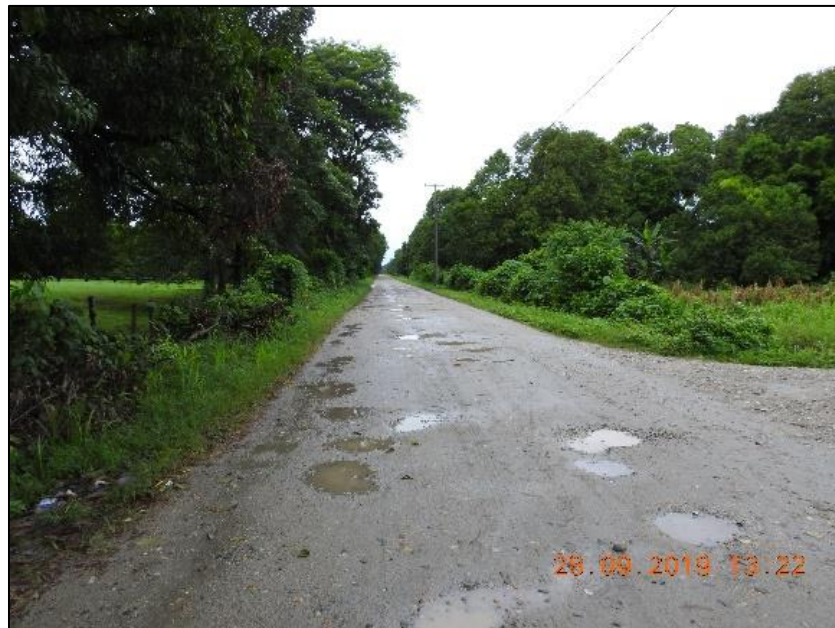
Figura VII.10 Vista de las condiciones actuales del camino.
