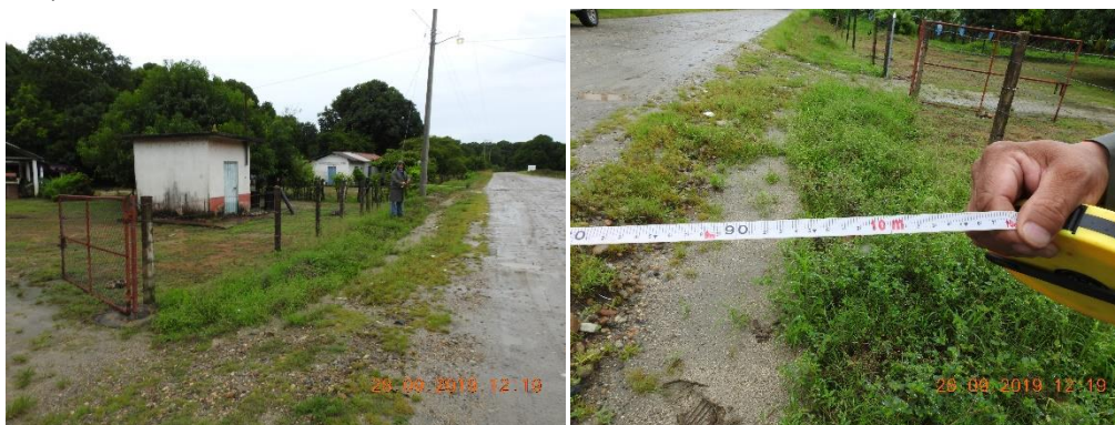
Figura II.6 Imágenes de las condiciones actuales del camino donde se evidencia el ancho necesario para la modernización.
