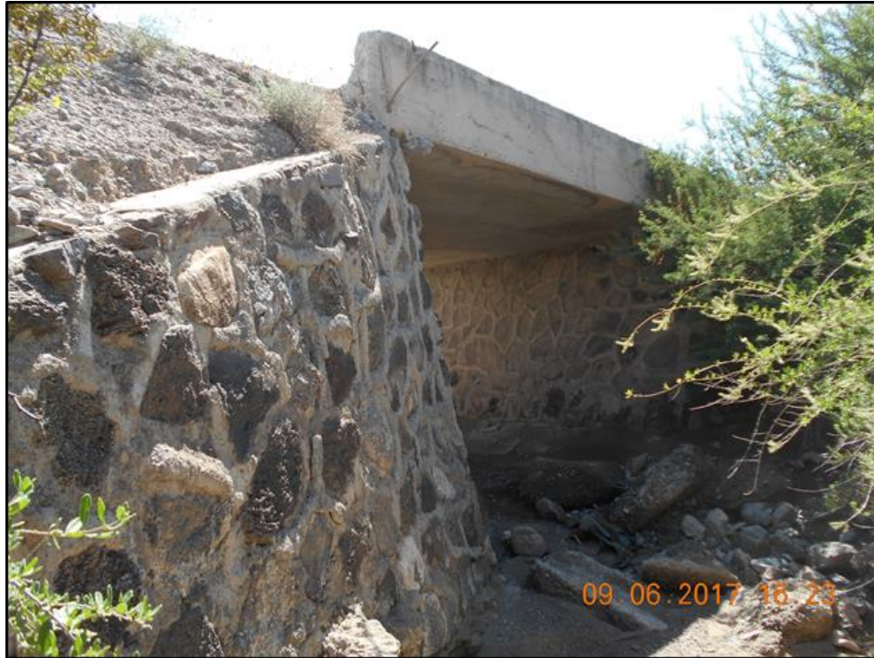
Figura VI.23 Ejemplo de una obra de drenaje en la zona del proyecto “E.C. (Acapetahua – Mariano Matamoros – Soconusco, tramo del km 0+000 al km 8+400)” la cual tendrá que ser modernizada a un paso de fauna.
