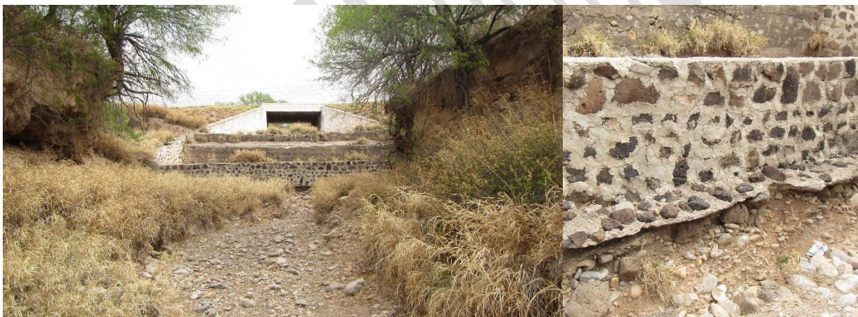
Foto IV-2 Proceso de erosión en la base de una de las alcantarillas. Tomado del estudio hidrológico.
