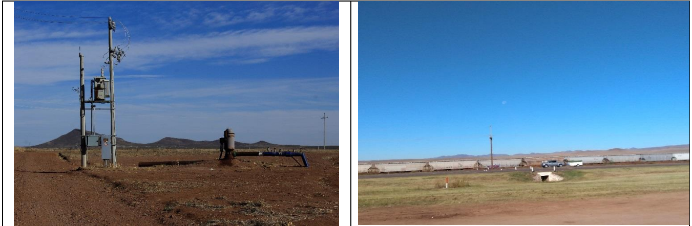
Figura 5 Aprovechamiento subterráneo y a un costado la vía 45 D y FF.CC. en ambos costados del área de proyecto
