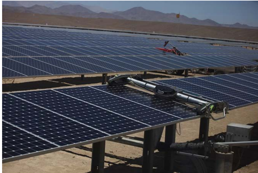
Figura II.22 Limpieza automática de los paneles solares
