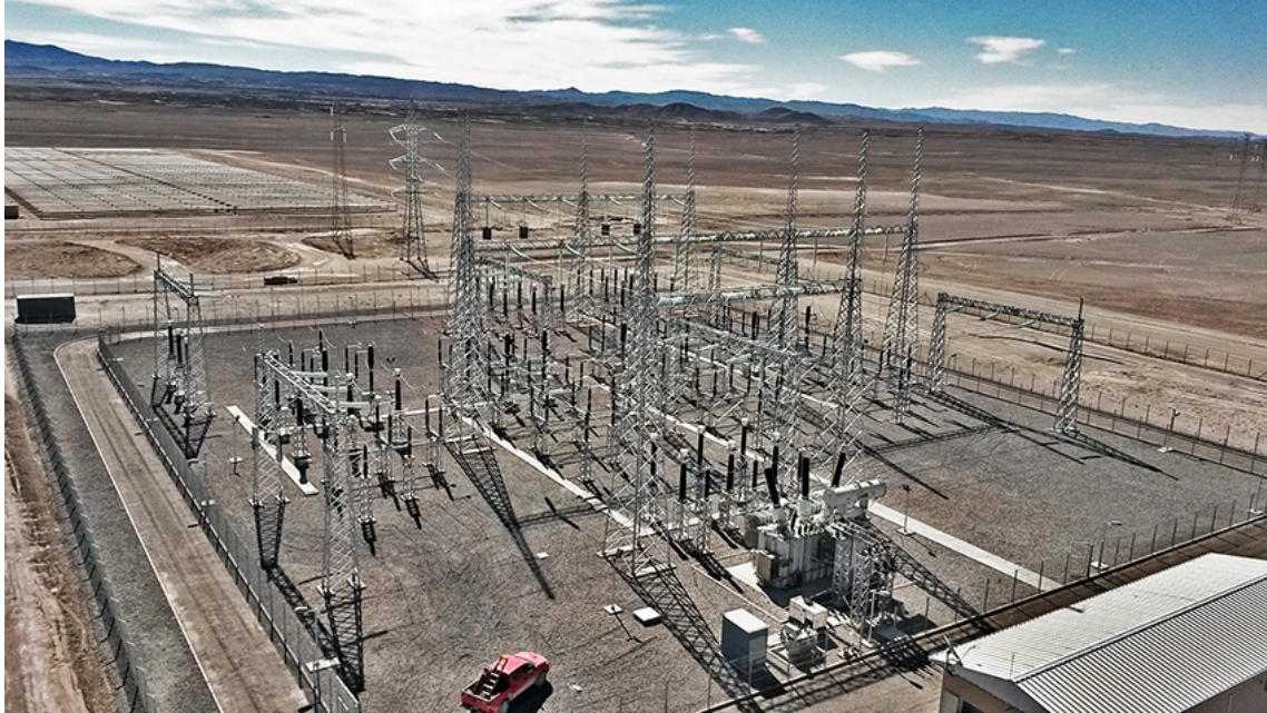
Figura II.9. Ejemplo de una subestación elevadora
