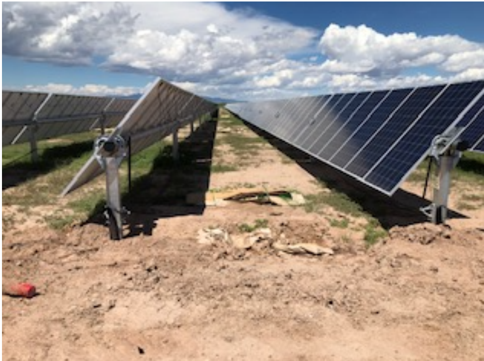
Figura II.6. Ejemplo de instalación de paneles fotovoltaicos en el Parque Santa María
