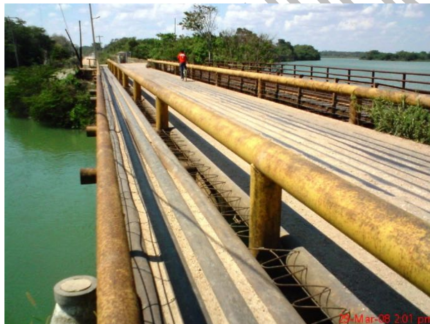
Figura IV.2.35. Puente de acceso al poblado Cap. Felipe Castellanos Díaz, Balancán, Tabasco. Infraestructura de la línea férrea del Mayab que cruza el río San Pedro.
