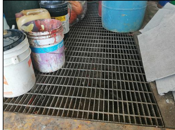
Fig. 24.- Dique para la contención de algún derrame de residuos peligrosos.
