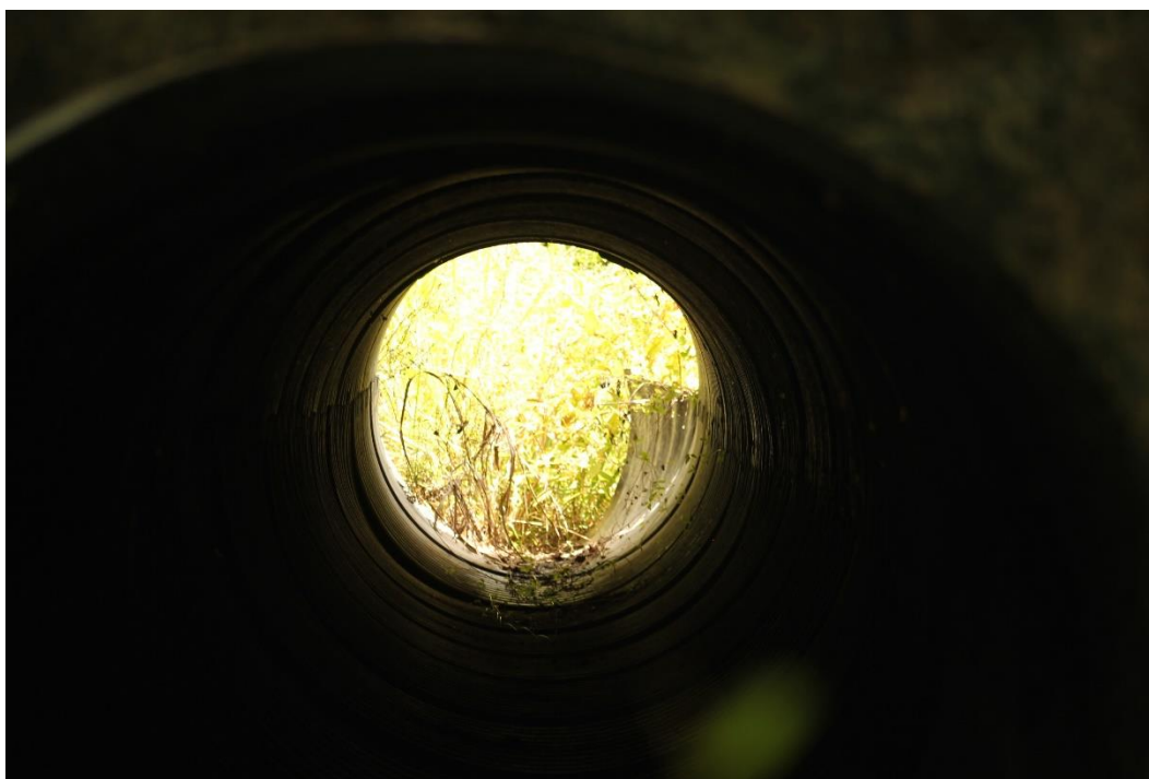
Figura 64. Obra de drenaje que será modernizada para permitir el flujo hídrico intermitente y evitar la afectación del camino, además de considerar adecuarlas como pasos de fauna.
