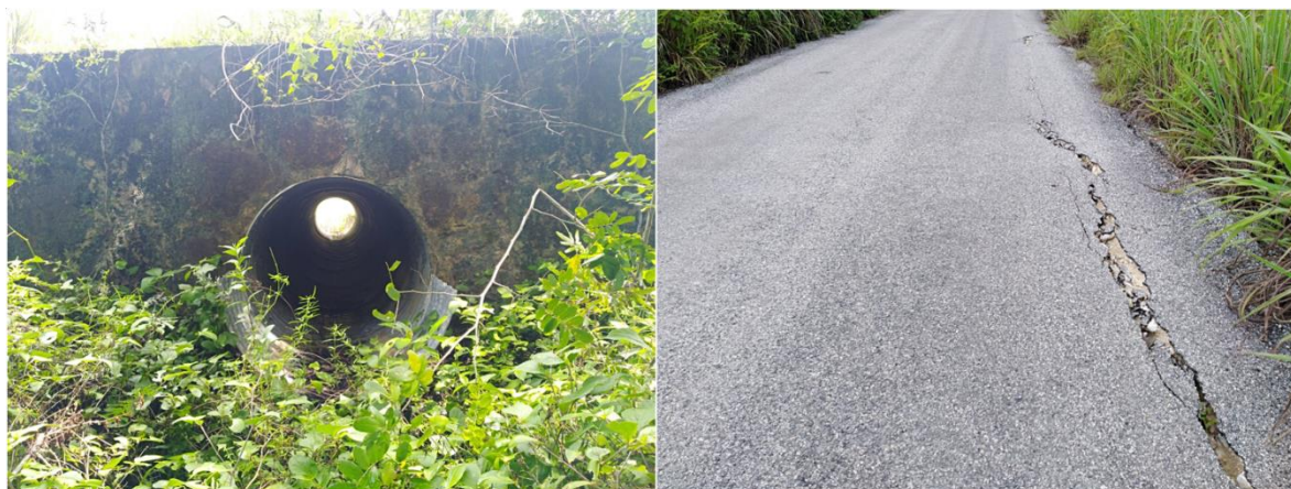
Figura 41. Obra de drenaje que será modernizada para permitir el flujo hídrico intermitente y evitar la afectación del camino, mismo que actualmente presenta grietas en algunas áreas.
