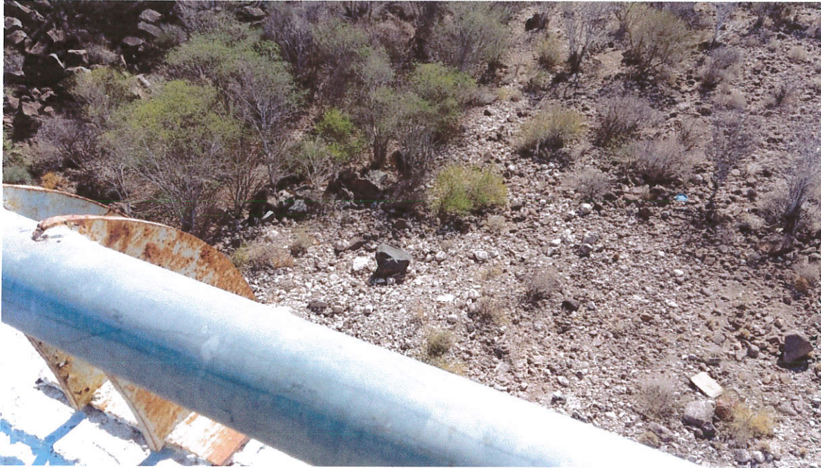
Foto 54 Vista del cauce del arroyo San Juan tomada desde el barandal del puente
