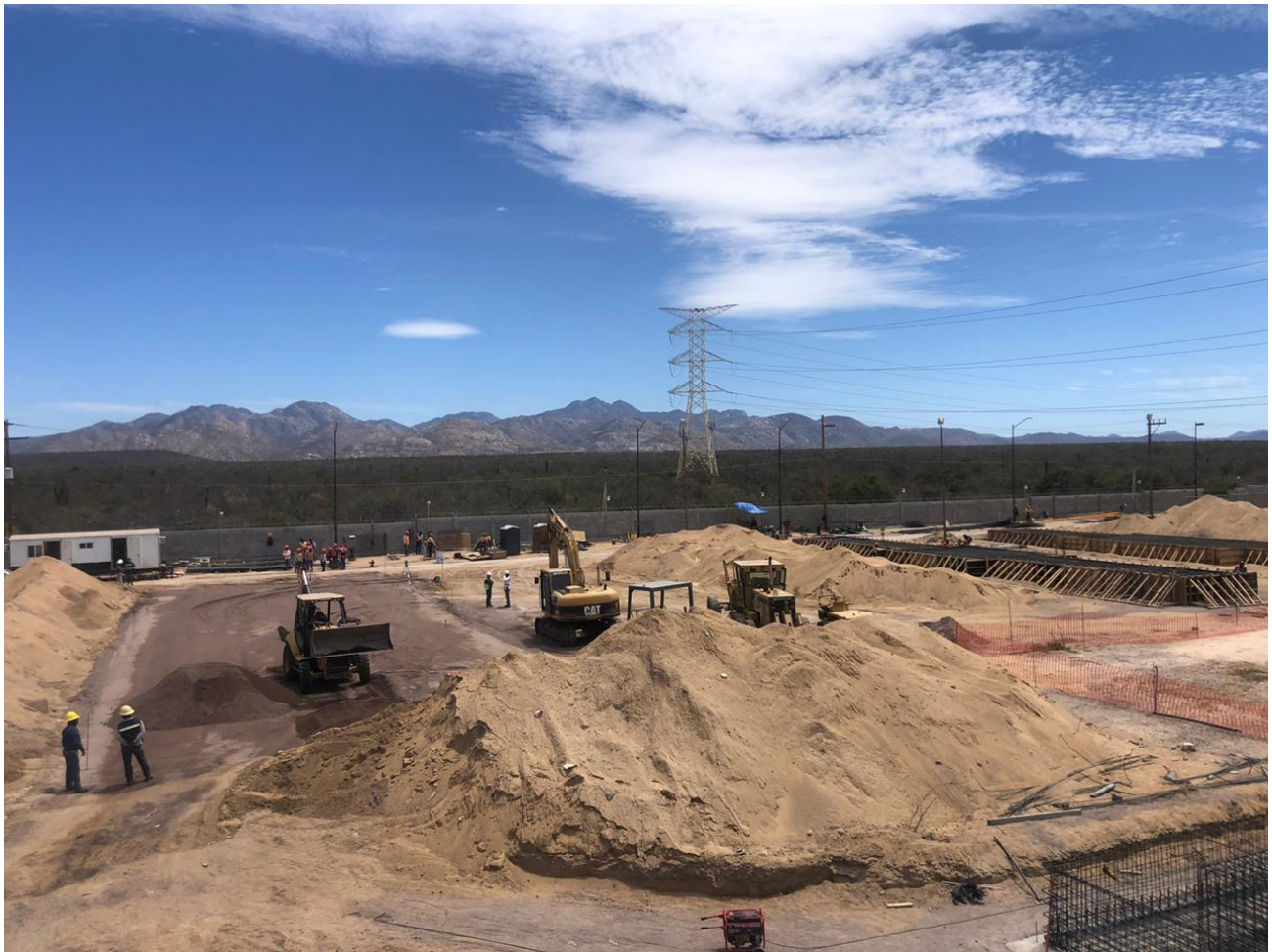
Figura II.15. Ejemplo de obras de preparación de sitio que se realizarán para el proyecto
