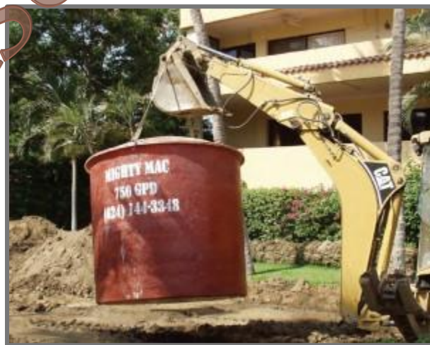
Figura II-33. Planta de tratamiento de aguas residuales Mighty mac 750.
