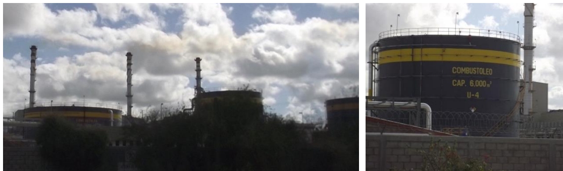
Vista de la Central Termoeléctrica Punta Prieta
