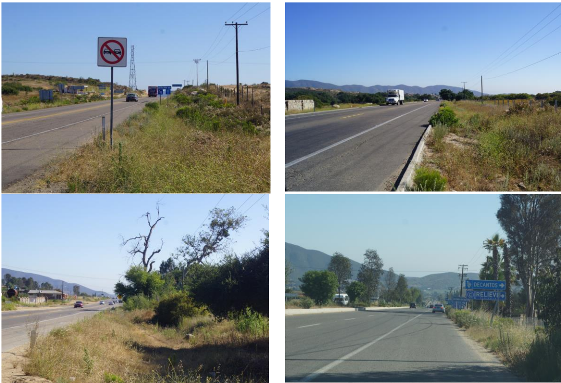
FIGURA II- 32 CONDICIONES DEL TRAMO
