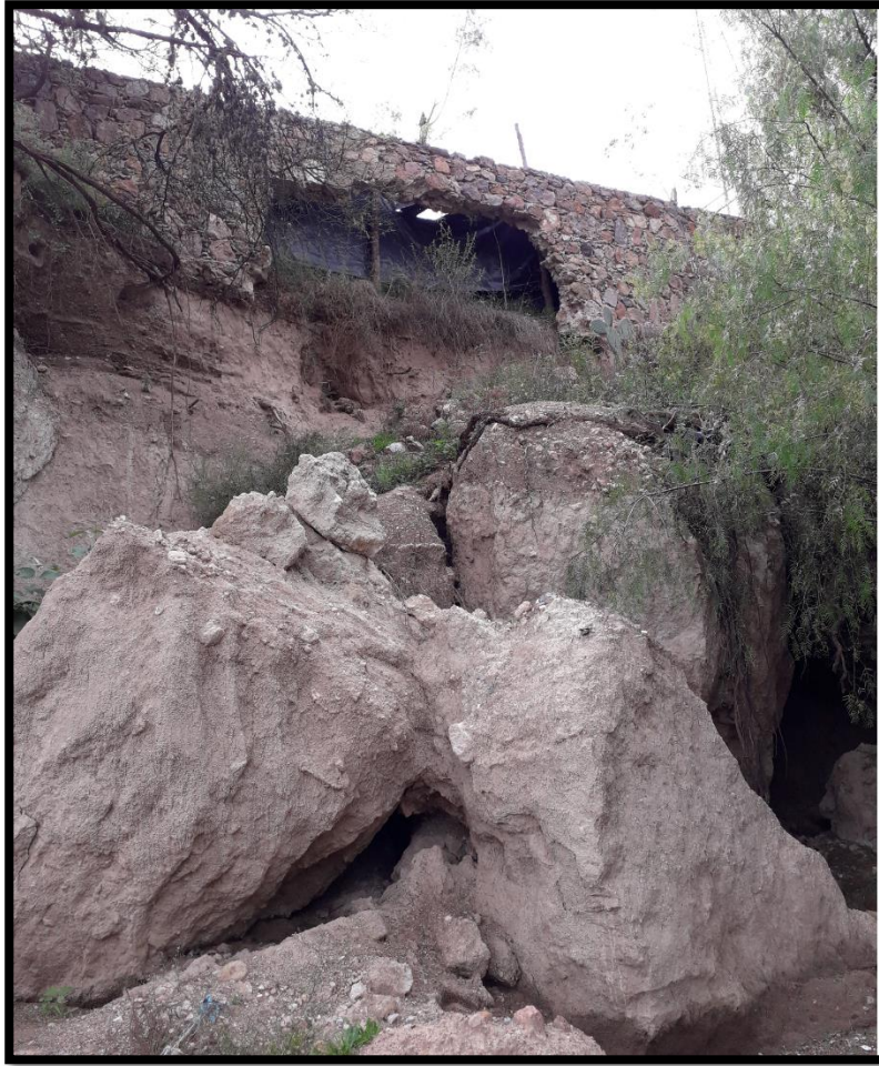
Derrumbes en el talud del arroyo y el muro que delimita la propiedad del promovente.
