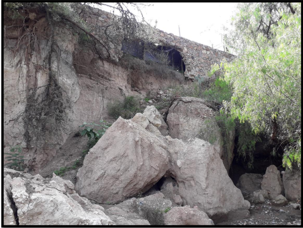
Figura 10. Socavones y derrumbes en el talud del cauce del arroyo Piedras Negras, en el sitio del proyecto.
