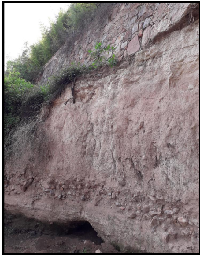
Figura 11. Avance de la erosión en la base del talud del arroyo Piedras Negras, en el sitio del proyecto.
