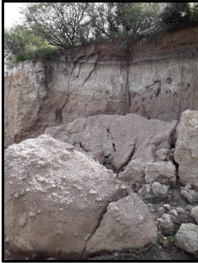
Figura 12. Derrumbe en el talud del arroyo Piedras Negras en el sitio del proyecto.
